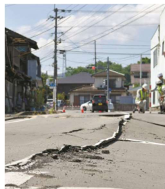
ひび割れや陥没が生じた道路 7月31日、宇城市小川町 しんぶん赤旗 8/16 号より
