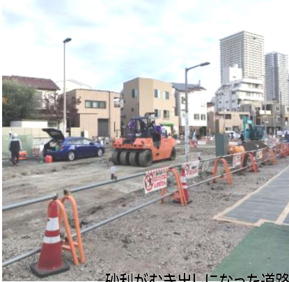
砂利がむき出しになった道路
