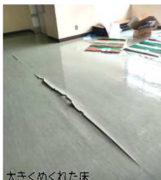
大きくめくれた床
