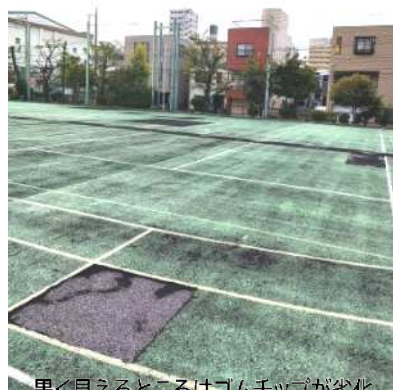
黒く見えるところはゴムチップが劣化（手前は四角くはがれています）
