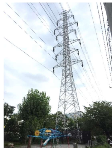
宮前公園内の鉄塔 ←
