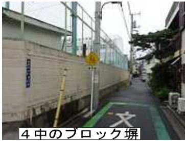
4中のブロック塀
